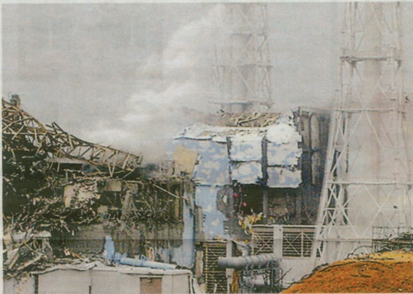
Den skadade fjärde reaktorn i Fukushima. Bild från i tisdags, den 15 mars.
