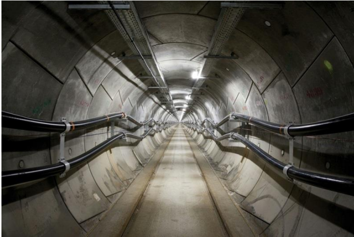
Figur 9. Interiör från tunneln för högspänd likström under Pyrenéerna (källa [6].)
